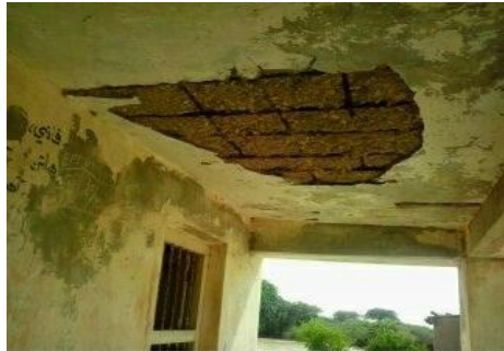
Damaged, One room GBPS Jaati, جڏهن آمريڪي واچوڙو يا مٽيءَ جو طوفان، سنڌ
